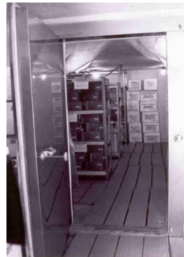
Foto 48 Vista interna de la cámara fría.
